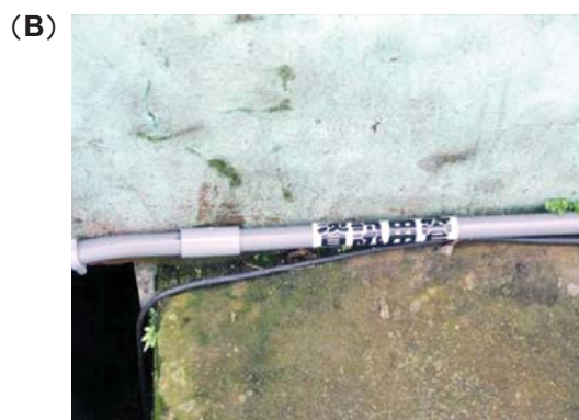
生物防治分場光纖網路管路配置概況 A：第一棟出 B：光纖管線標示
