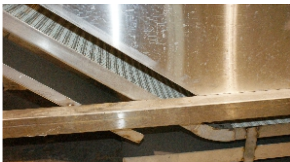
滾筒沈浸式輸送機加裝底盤回收蠟劑，避免外漏及浪費
