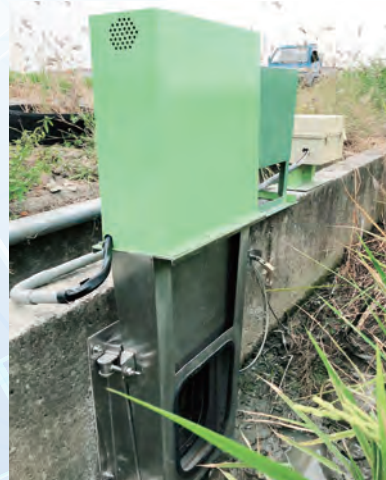
▲ 水田監控管理系統垂直升降式電動水閘門，與水田傳感器與田間挹動器整合，進行田間自動灌溉（國立中興大學提供）
